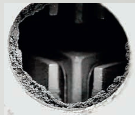
Fig. 31: Sedimentos en la válvula de retención
